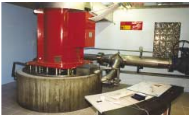
Le groupe turbo-générateur d'une puissance de 753 kW.
