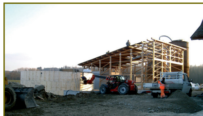
Digesteur et halle de réception (12.2006)
