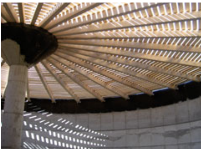
Intérieur du digesteur
