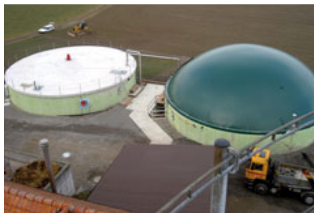
Installation de biogaz à Uttewil (FR)
