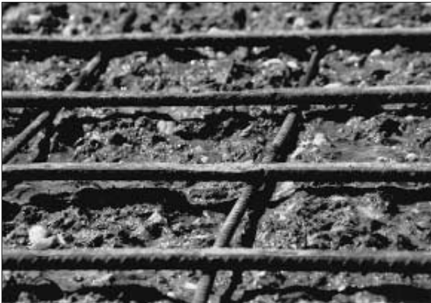
Figure 6.16: Etat d'un tablier après un décapage hydrodynamique.
