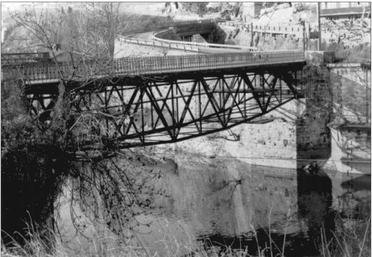
Figure 7.9: Pont routier en acier ; renforcement du treillis métallique par de l'acier.
