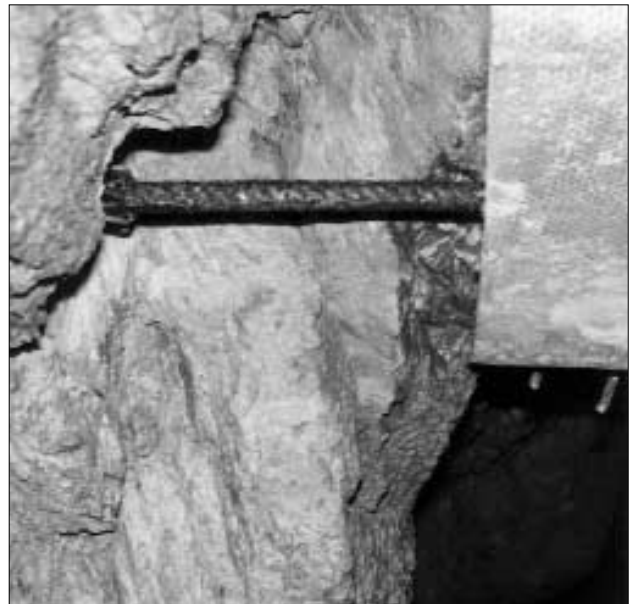
Figure 5.7: Eclatement du béton et ancrage corrodé
