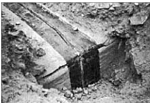
Figure 3.15: Etanchéité endommagée sur la face extérieure de la toiture d'une galerie (côté vallée), et angle paroi/toiture endommagé côté montagne
