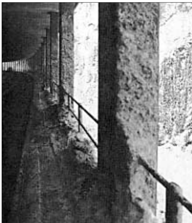
Figure 3.11: Bouillie de neige collée aux appuis de la galerie; son effet est comparable à celui d'une projection d'eau
