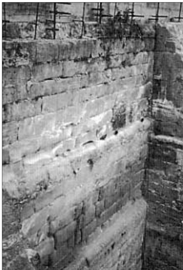
Figure 7.12: Dégradation généralisée du mur de soutènement de l'esplanade du Münster à Berne: l'humidité saline, provenant du remplissage la face arrière, a transpercé le mur, rongé le grès
