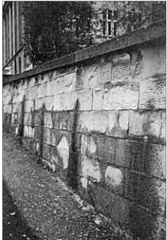
Figure 7.10: Formation de croûtes sur de la pierre de grès: mur de soutènement à Zürich
