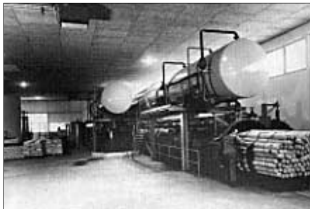
Figure 6.21: Installation industrielle d'imprégnation du bois sous pression
