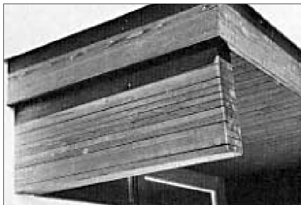
Figure 6.11: Le lamellé-collé se délamine s'il est soumis à de fortes intempéries et que son collage n'a pas été soigné
