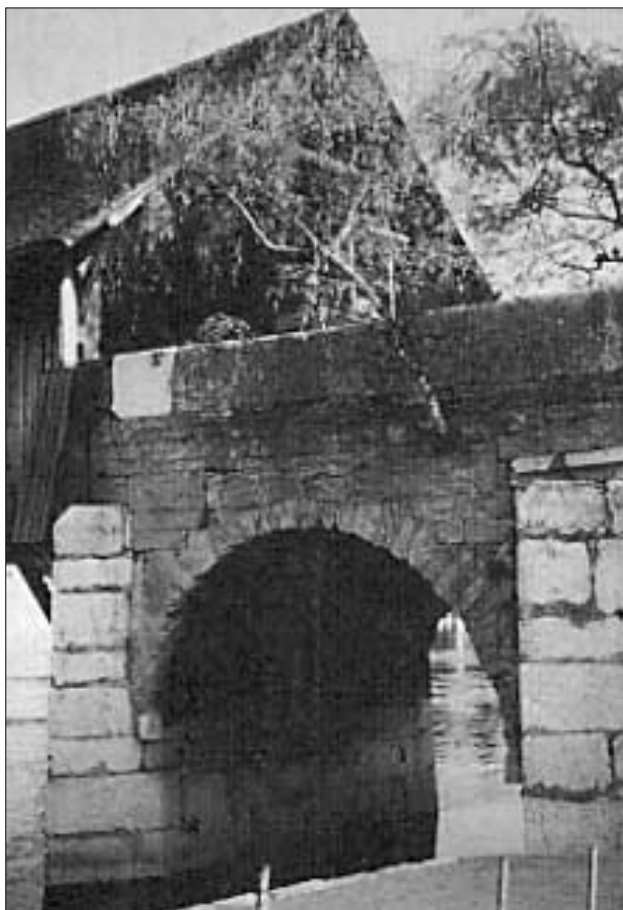
Figure 7.11: Les racines de bouleau transpercent le «Holzbrücke» à Olten
