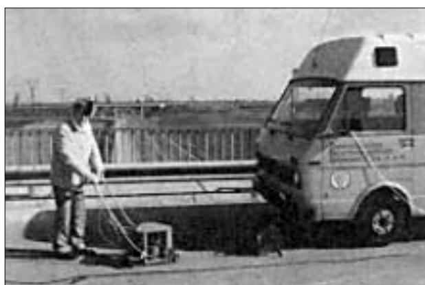
Figure 4.37: Localisation des fuites à l'aide de gaz traçant [4.60]
