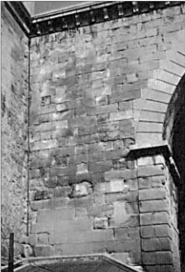
Figure 7.9: Dégradation généralisée au pont de Nydegg: les eaux de ruissellement entraînent une désagrégation sableuse considérable par cristallisation saline
