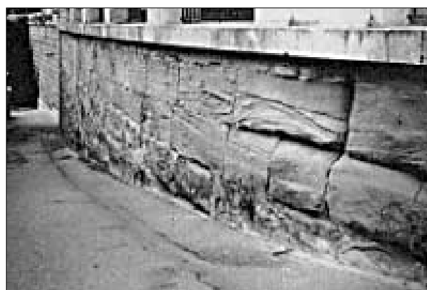
Figure 7.8: Désagrégation sableuse caractéristique: mur en grès près du Palais fédéral à Berne
