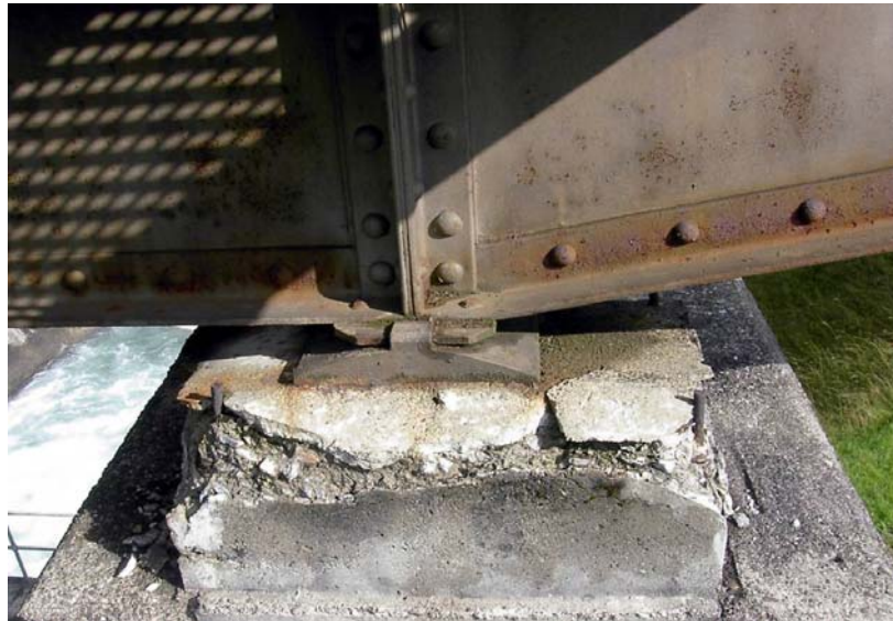
Dommages considérables dus au gel d'un appui d'un pont de service d'un barrage mobile.
