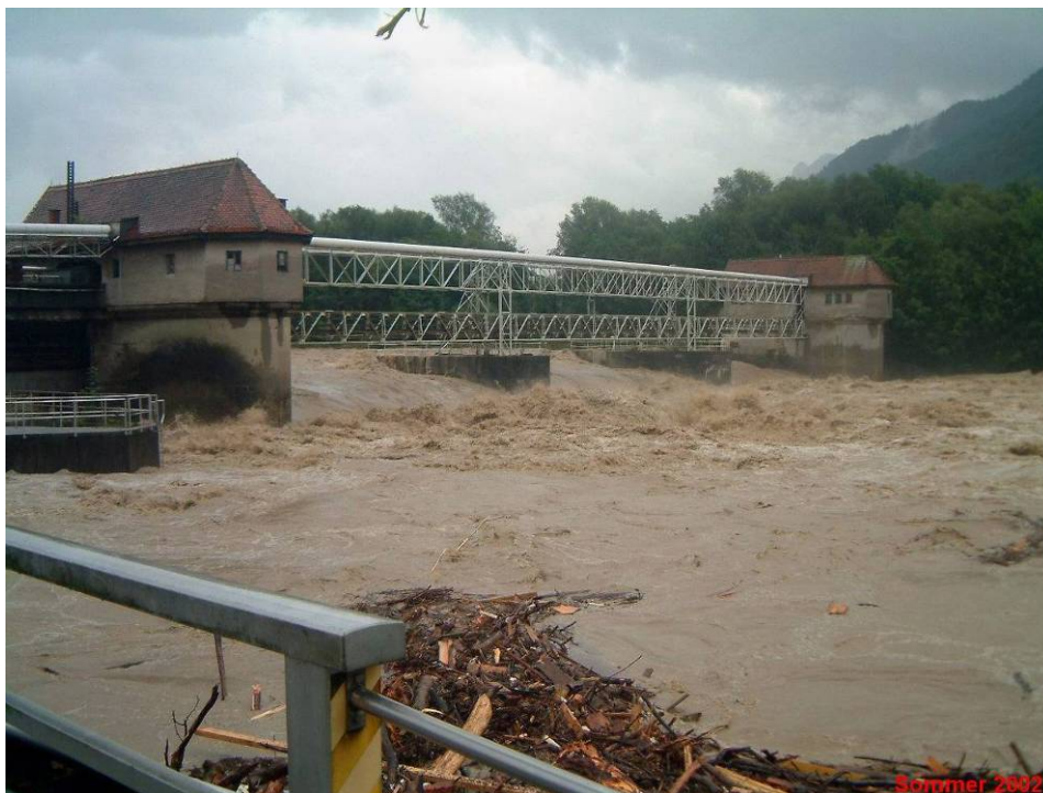
Le même barrage mobile (barrage-toit) pendant un hiver froid (en haut) et lors d'une crue (en bas).
