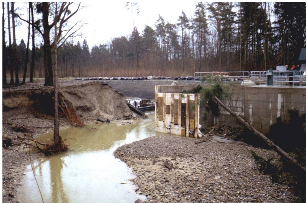
Petite centrale électrique (partie du barrage à droite sur la photo) : submersion dans le secteur latéral après que la vanne d'un évacuateur ne s'est pas ouverte lors d'une crue.
