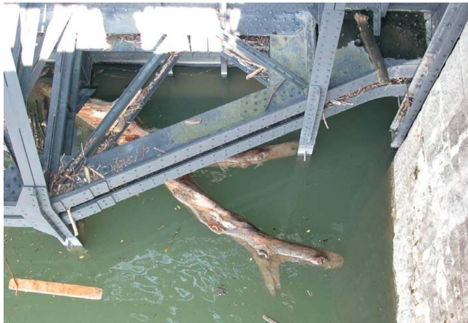
Tronc d'arbre coincé dans la structure d'une vanne.
