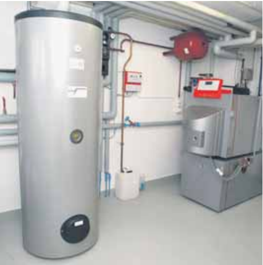
Une production de chaleur efficace est garantie avec une chaudière à mazout moderne
