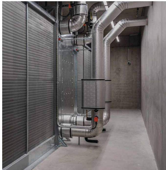
Vue sur l'échangeur de chaleur air/eau. Il transmet la chaleur de l'air chauffé à un circuit d'eau qui la transporte jusqu'à la centrale de chauffage. Là, elle alimente en énergie des pompes à chaleur qui augmentent la température pour le réseau de chauffage à distance. (Photo: Infomaniak)
