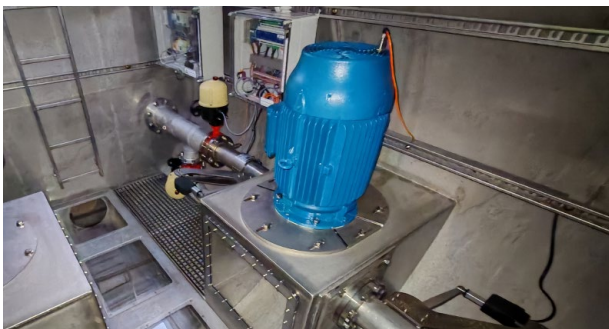
Petite turbine Pelton standardisée de 15 kW pour un débit de 32 l/s et une chute nette de 58 m, mise en service en janvier 2026, utilisant l’eau potable de la commune de Zillis-Reischen (GR) (source: ENSY AG)
