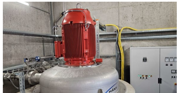
Petite turbine Pelton spécialement dimensionnée pour le site, de 117 kW pour un débit de 30 l/s et un chute nette de 467m, mise en service en septembre 2025, utilisant l’eau potable de la commune de Schwanden (GL) (source: Häny & Kobel Elektrotechnik AG)
