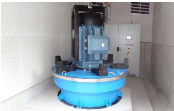
Centrale hydraulique de Furlibach, turbogénérateur Pelton à 6 injecteurs © fmb Ingenieure
