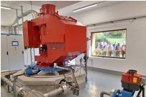
Le turbogénérateur Pelton de la centrale de la Montoz, lors de l'inauguration le 31.10.2024 (source : Mhyllab)
