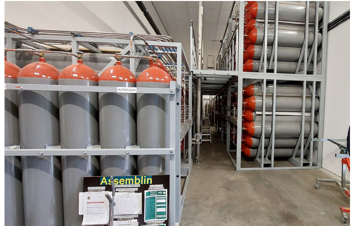
Stockage intermédiaire de gaz au dépôt de bus à Uppsala. Photo : OST
