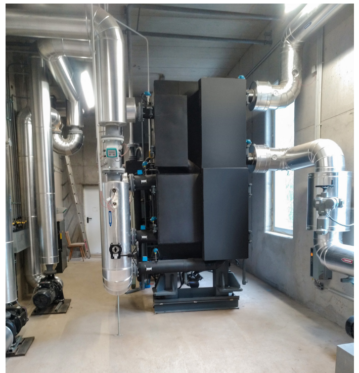
Une pompe à chaleur à absorption peut permettre d'augmenter le rendement thermique des chaudières à bois de plus de 1 MW de 20 à 25%, voire plus. Photo : StepsAhead
