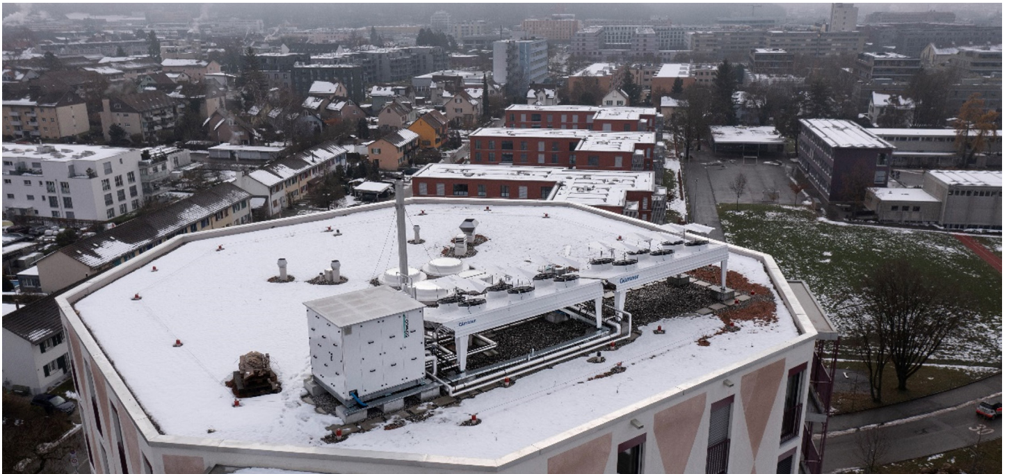
Un des exemples de combinaison d'un chauffage au bois avec une pompe à chaleur : sur le site de la raboterie à Winterthur (lot de construction 2), une pompe à chaleur air-eau (225 kW) couvre depuis 2022 les besoins de base en chauffage et en eau chaude. En cas de besoins de chaleur plus importants, un chauffage à pellets (200 kW) est également utilisé. Photo : Scheco AG
