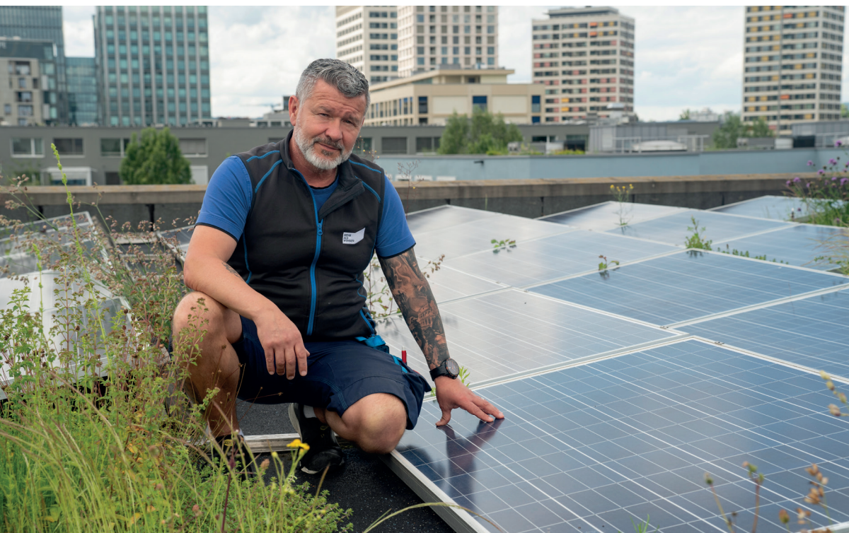
Dans les quartiers de Hunziker à Zurich et de Hobelwerk à Winterthur, des installations photovoltaïques installées sur les toits contribuent à alimenter les appareils de séchage situés au sous-sol des bâtiments.
