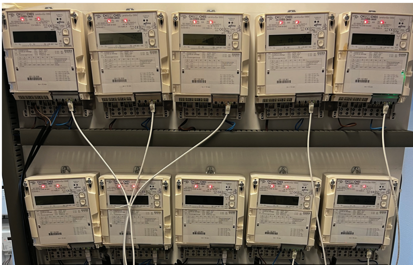
Dispositif de test pour l'essai sur le terrain dans le laboratoire de Romande Energie à Morges. Photo : Romande Energie
