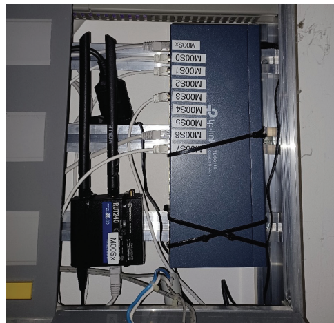
Modem et routeur tels qu'ils ont été utilisés lors de l'essai sur le terrain à Rolle. Photo : Romande Energie/HSLU
