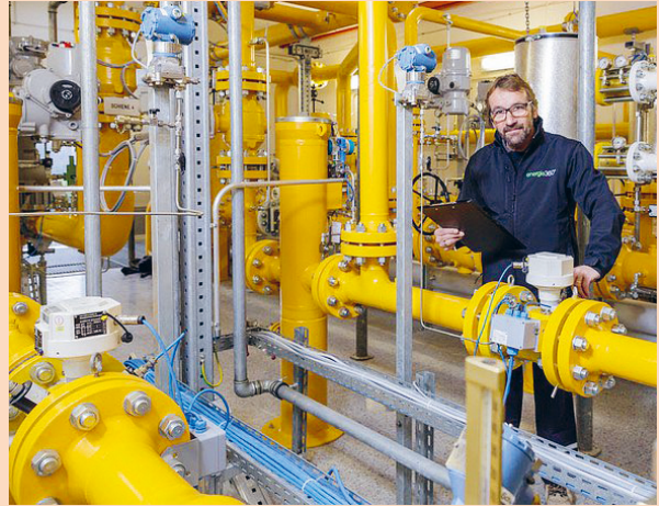
Figure 3: Station de mesure et de réduction de pression (source: Energie 360°).
