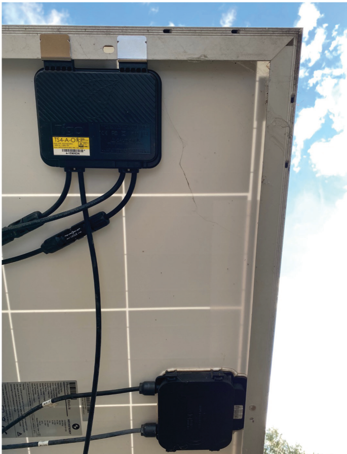
Les optimiseurs de puissance sont fixés directement sur le module photovoltaïque et sont soumis à une charge thermique considérable. Photo: Tigo Energy
