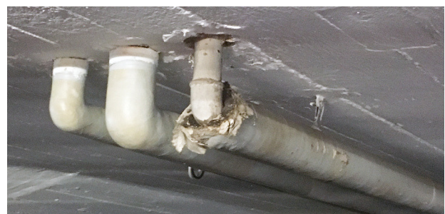
Réparer les isolations abîmées.
