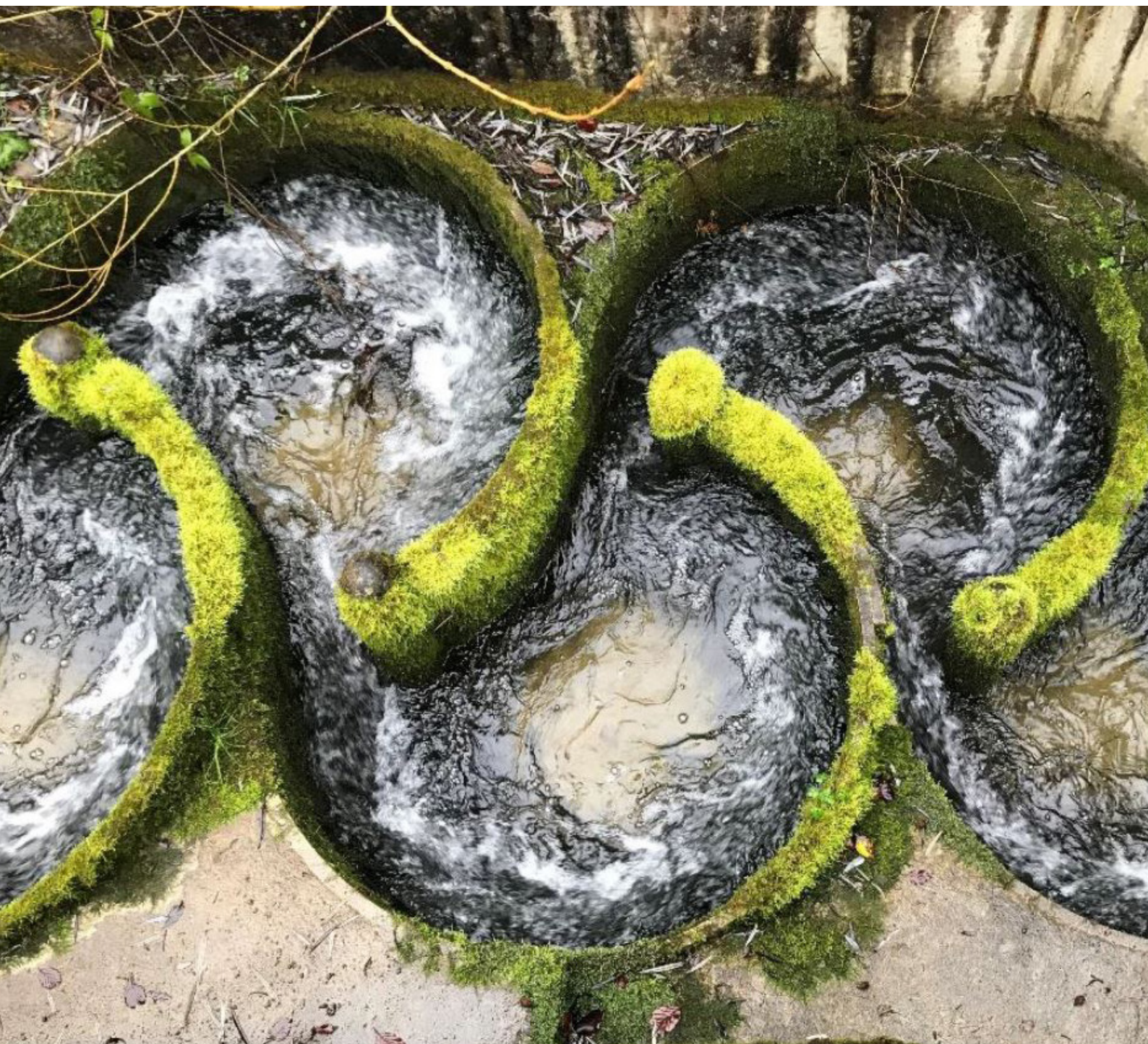
Sortie d'une passe à poissons à bassins circulaires (Photo: IUB/Fischwerk)
