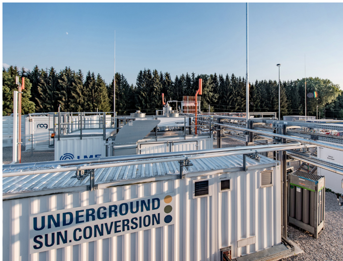
Installation pilote de géométhanisation dans un gisement de gaz naturel exploité à Pilsbach, en Autriche. À une profondeur de 1 000 mètres, l'hydrogène et le CO 2 sont transformés en méthane par des archées, et ce à des pressions pouvant atteindre 107 bars et à une température de 40°C. Photo: RAG Austria AG
