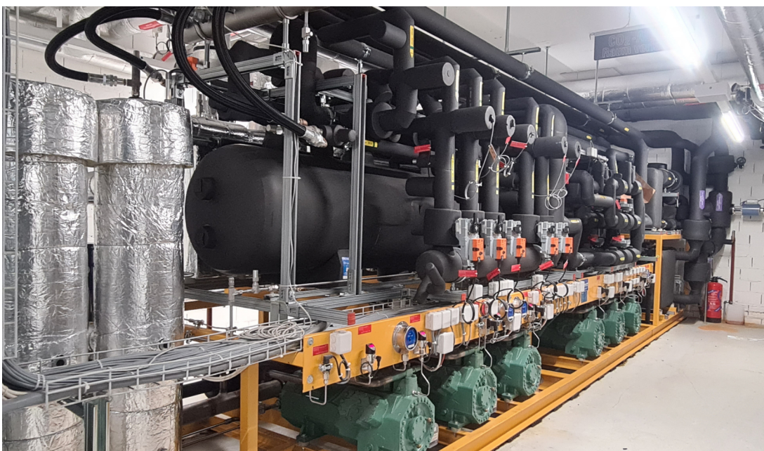
Vue sur l'une des deux pompes à chaleur CO 2 réversibles du Surseepark. L'installation a une puissance de chauffage de 550 kW et une puissance de climatisation de 630 kW. Photo: Coopérative Migros Lucerne
