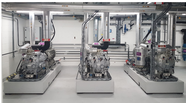
Figure 4 : Vue dans la centrale combinée de refroidissement et de chauffage. A gauche les deux compresseurs de réfrigération et à droite le compresseur de la pompe à chaleur.
