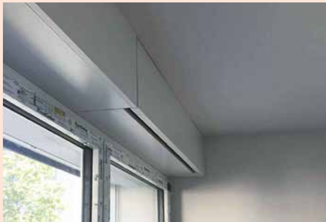
Figure 3.16: Appareils VPL intégrés dans l'élargissement des cadres de fenêtres, sans complication particulière. (Source: Ventoswiss AG)
