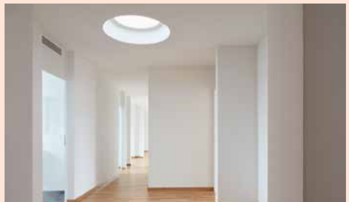
Figure 3.11: Par la bouche d'air disposée au-dessus de la porte de la salle de bain (à gauche), l'air fourni parvient dans le couloir. Une circulation conventionnelle de l'air aurait impliqué un faux-plafond recouvrant la lumière zénithale. (Source: Ralph Feiner)
