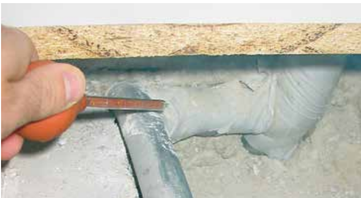
Figure 2.4: Zone d'installation encrassée par les fuites d'air passant d'un appartement à un autre. (Source: Haute école de Lucerne)
