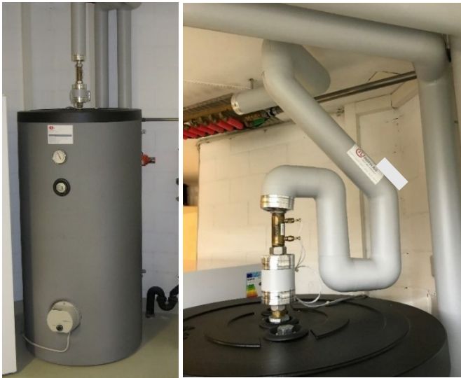
Figure 22 : Ballon d'eau chaude sanitaire, installation 20. A droite, montage ultérieur d'un siphon. Double mesure redondante de la température directement à la sortie.
