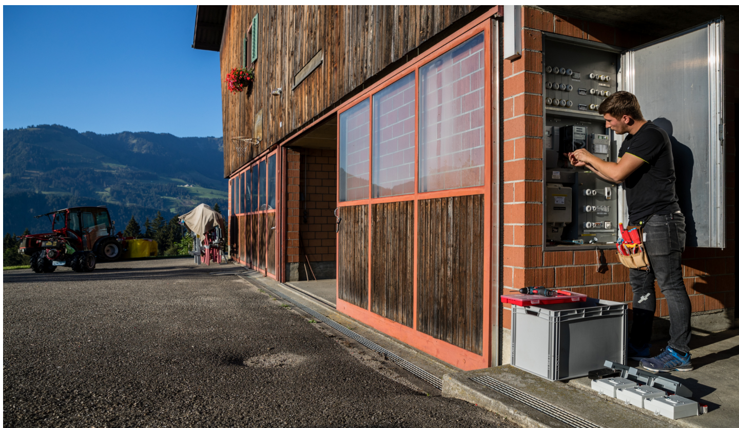
Un technicien de la CKW installe un compteur intelligent dans une ferme à Schüpfeim (dans le canton de Lucerne). Photo: CKW
