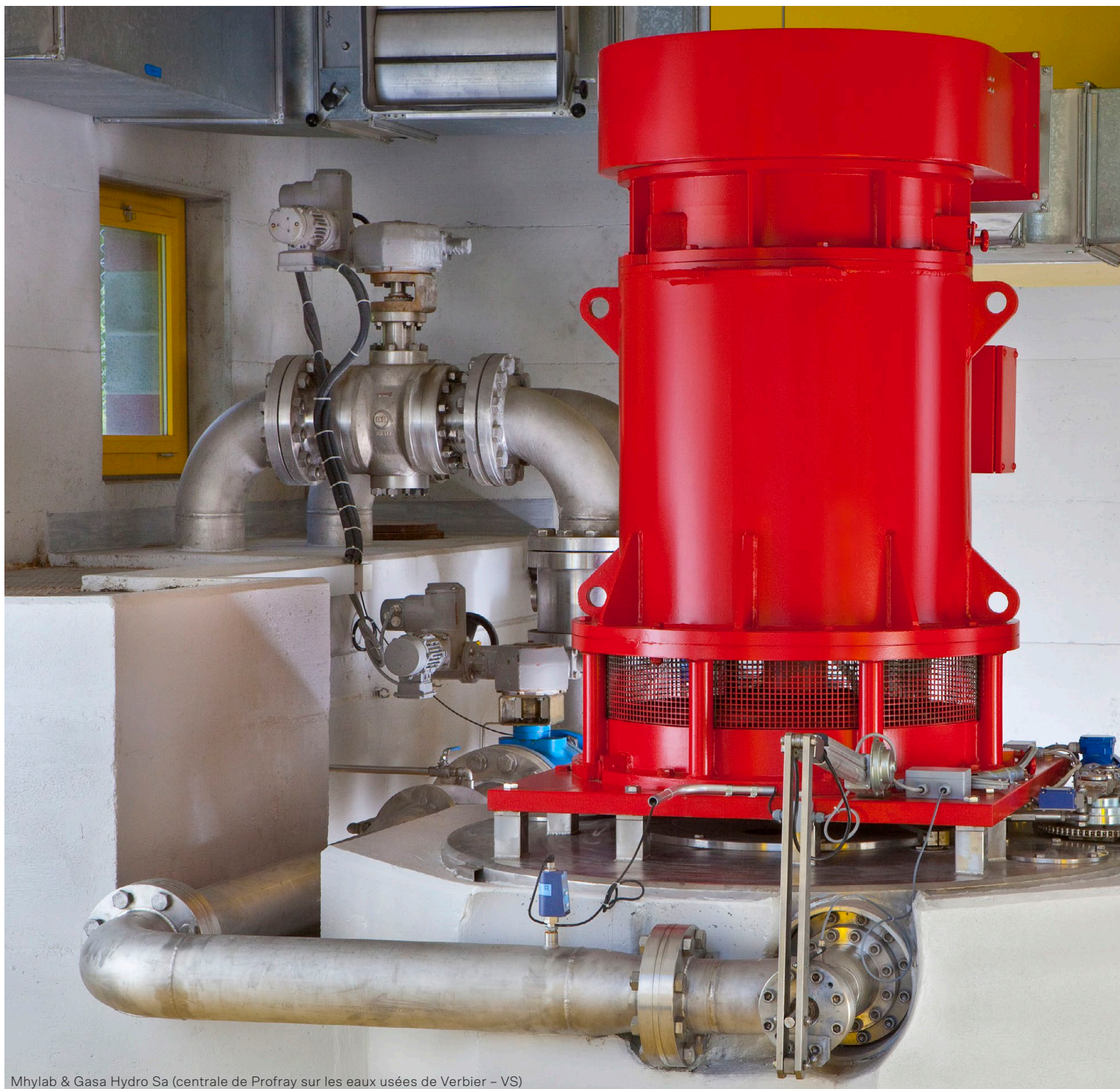
Mhylab & Gasa Hydro Sa (centrale de Profray sur les eaux usées de Verbier – VS)
