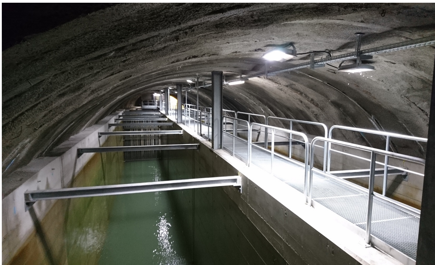
La caverne du désableur de la petite centrale hydroélectrique de Gletsch-Oberwald : le réservoir est utilisé comme réserve d'eau, ce qui permet une production d'électricité plus flexible à la centrale. Photo : FMV
