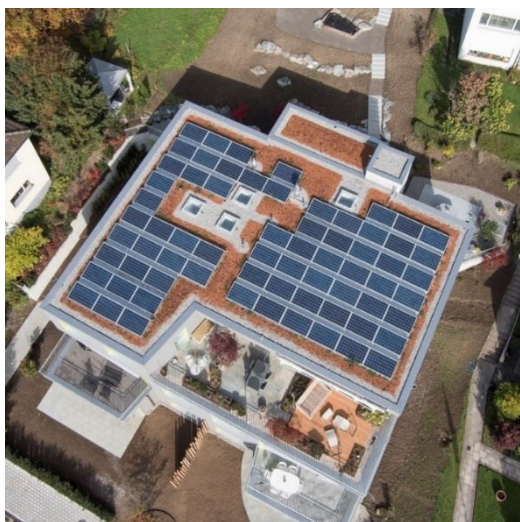
© BE Netz AG, installation sur toiture plate avec éclairages zénithaux à Stäfa
