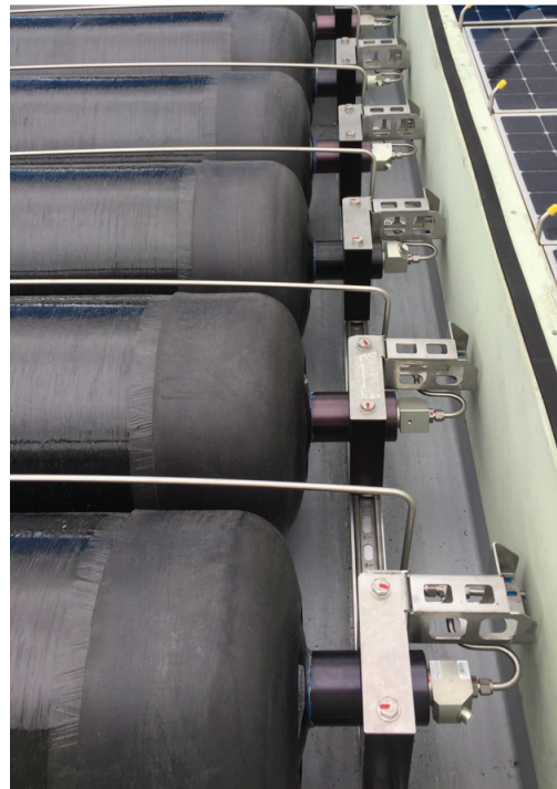
Chacun des 24 réservoirs de stockage d'hydrogène est équipé de trois dispositifs de sécurité de type thermofusible (TPRD). Photo : rapport final de l'OFEN
