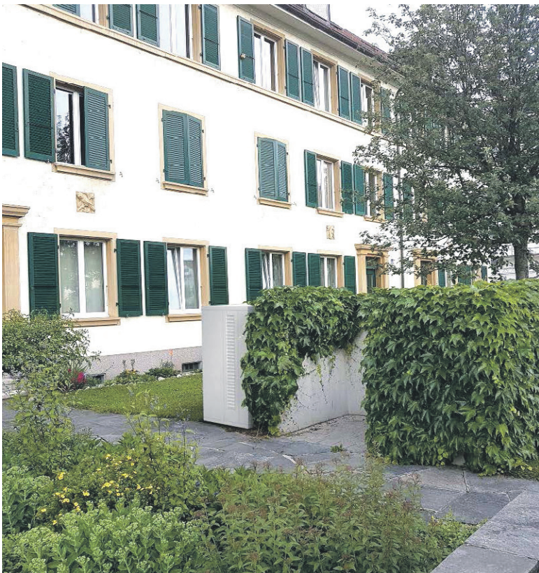
Ein gutes Beispiel für eine optimal in die Umgebung eingebettete Lösung: Links neben der mit Efeu bewachsenen Containerstation befindet sich die Ausseneinheit der Wärmepumpe.
