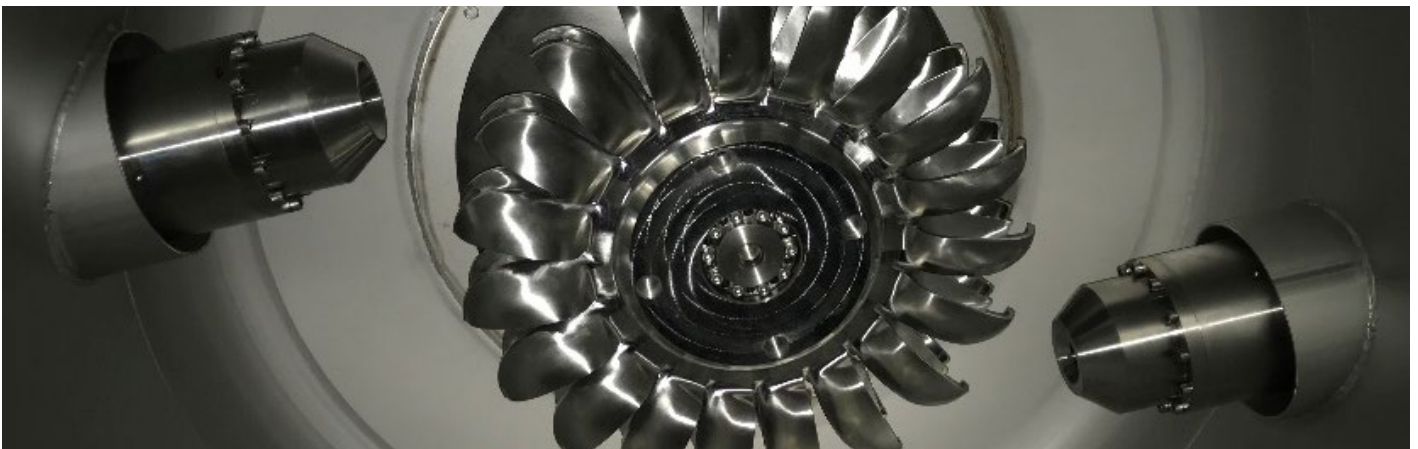
PCH de Malatray à Monthey: la roue Pelton et ses deux injecteurs aux sources différentes (source: Ville de Monthey)
