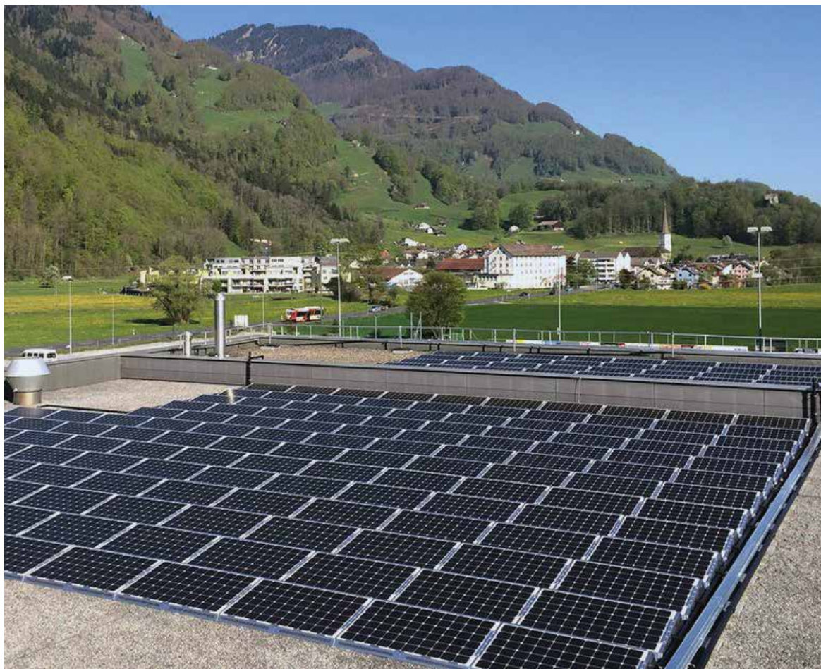
Modules thermiques photovoltaïques hybrides (PVT) sur le toit de la linth-arena sgu (source: ZHAW).
