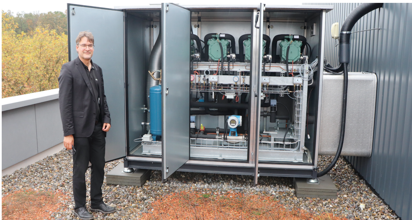
Le responsable du projet Stefan van Velsen (3-Plan Haustechnik AG) devant la pompe à chaleur air/eau avec ses quatre compresseurs. Ces derniers permettent une exploitation sur une plage de charge de 15 à 100%. Photo: B. Vogel
