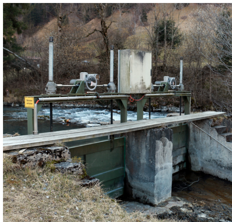
Usine d'ardoises de Frutigen: la prise d'eau
