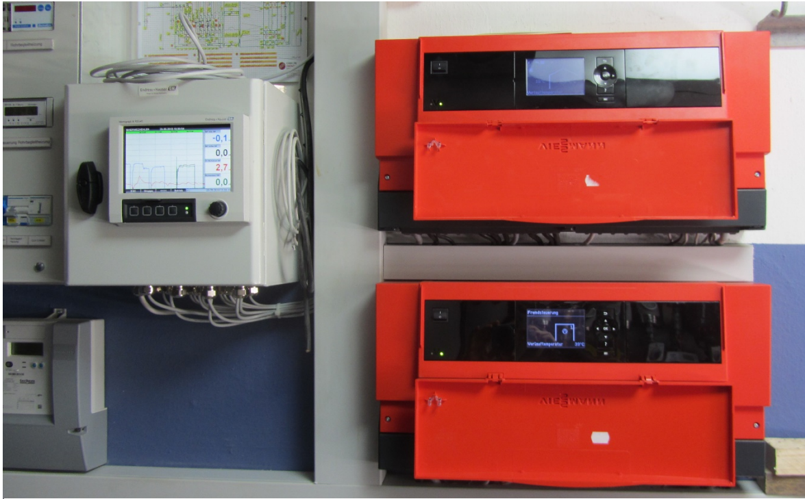
Abbildung 9: Elektrohauptverteilung, Logger und Wärmepumpensteuerungen (v.l.n.r.)
