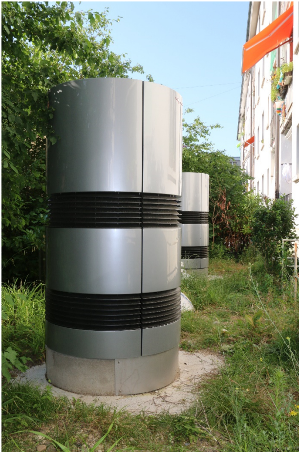
Abbildung 4: Luft/Wasser-Wärmepumpe mit geringem Abstand zu Mehrfamilienhaus Wiesenschanzweg 36
