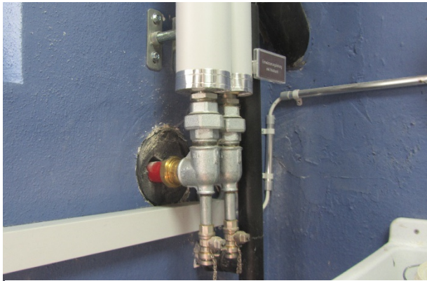
Abbildung 6: Kellereinführung der erdverlegten isolierten Leitungen
