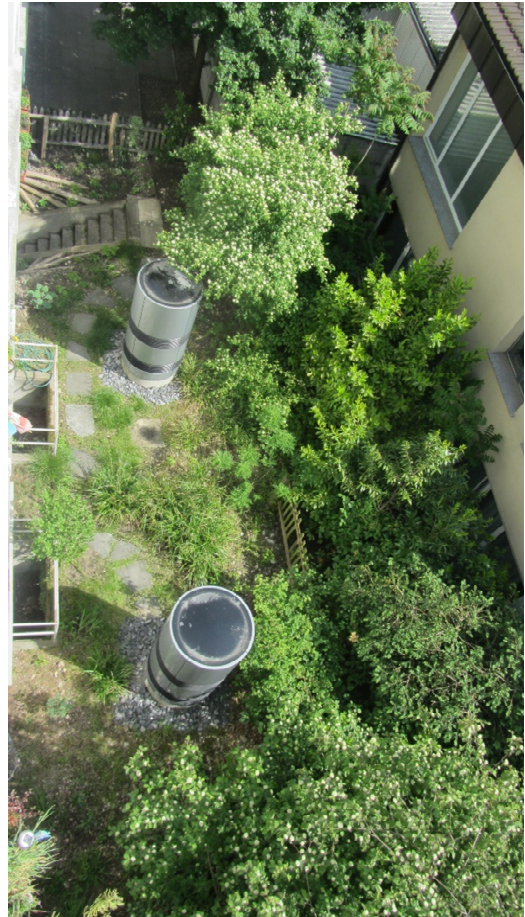
Abbildung 5: Luft/Wasser-Wärmepumpe mit geringem Abstand zu Nachbargebäude
