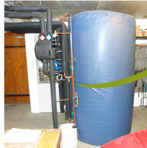
Temperaturbeständige Auslaflleitung führt zum Boden
