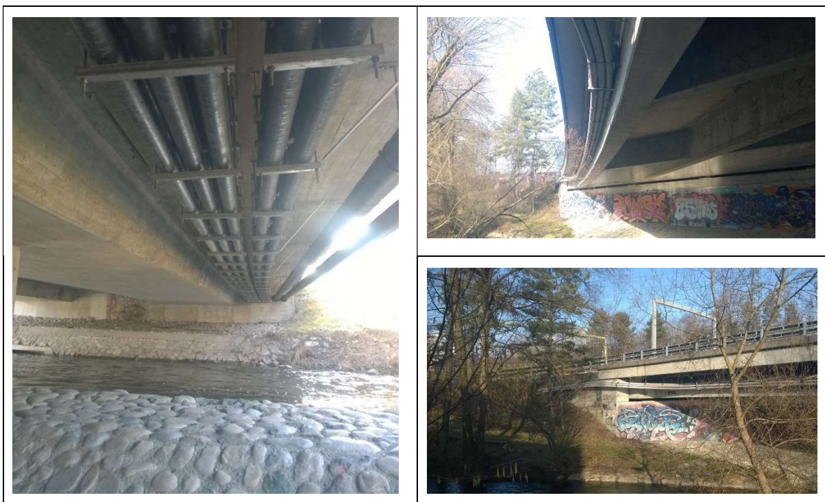
Abbildung 5: Brücken mit angehängten Kabelleitungen tieferer Netzebenen oder mit Kabeln der Trägerinfrastruktur
