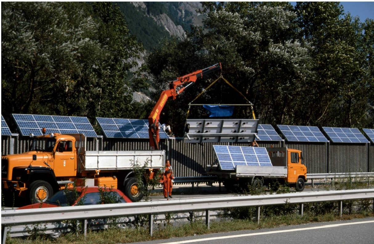
Abb. 5: Die Anlage an der A13 wurde Ende 1989 in Betrieb genommen
