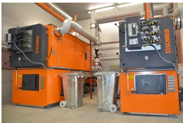
Holzchnitzelfeuerung Felben-Wellhausen (TG)
