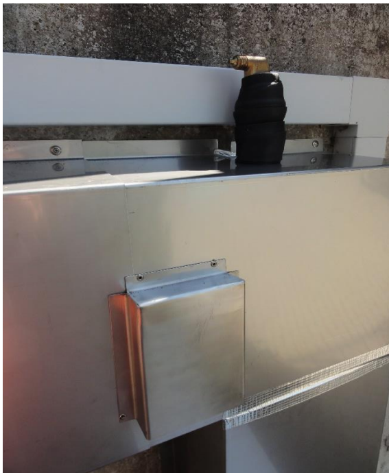
Abbildung 7: Revisionsöffnung in Hauptleitungen Heizung für Ventil
