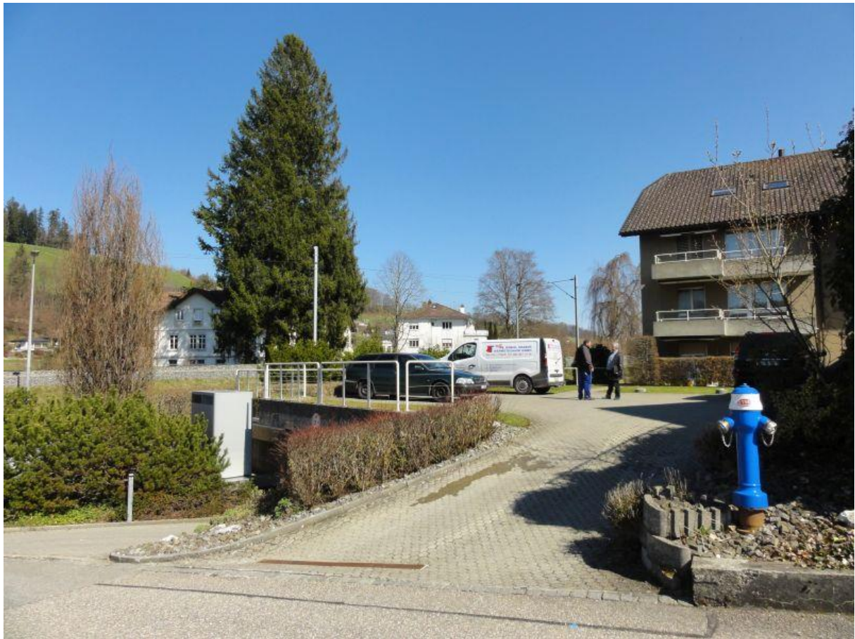
Abbildung 4: Situationsübersicht: Links im Bild neben der Garageneinfahrt die Luft-Wasser Wärmepumpe (grauer Kasten), rechts im Bild die Liegenschaft (braunes Gebäude mit Balkonen), in der Mitte der Aussenparkplatz
