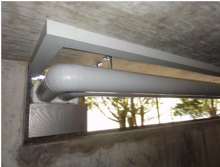
Abbildung 9: Hauptleitungen Heizung bei Eintritt in die Einstellhalle
