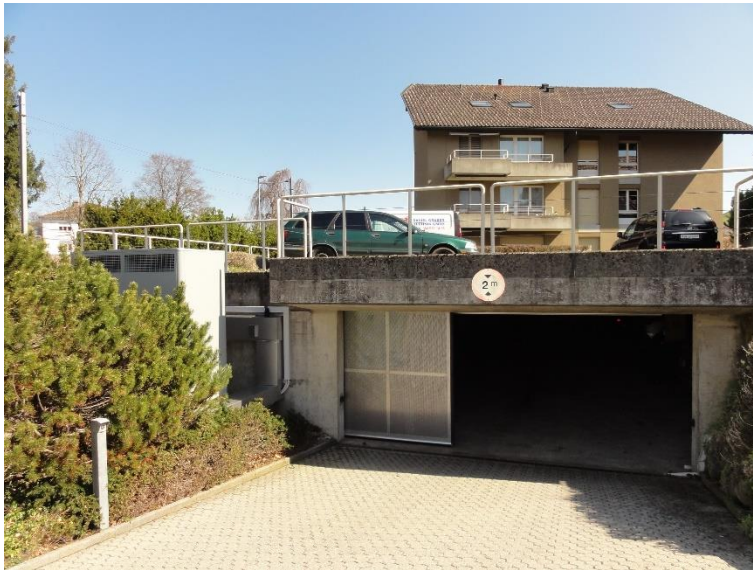
Abbildung 15: Ansicht der Luft-Wasser Wärmepumpe links der Garageneinfahrt, oberhalb im Bild sind Parkplatz und Liegenschaft.
