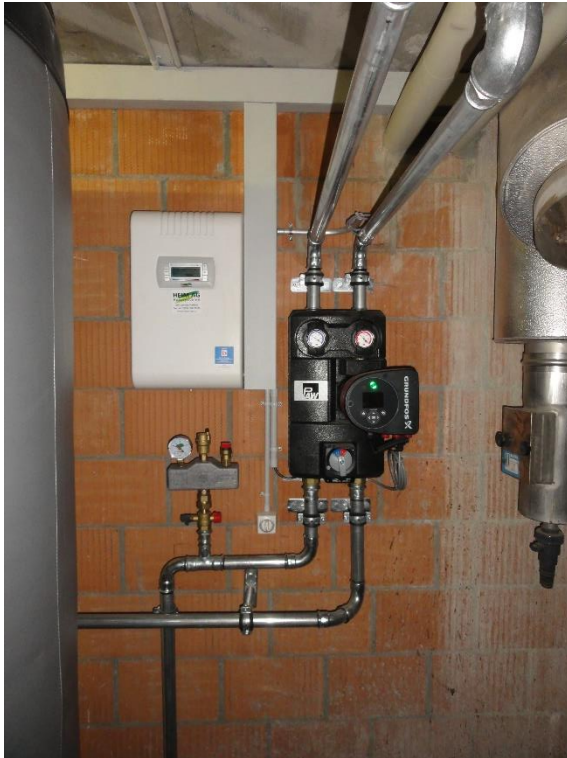
Abbildung 14: Steuergerät Wärmepumpe (links) und Verteilgruppe Wohnungen (unisoliert).
