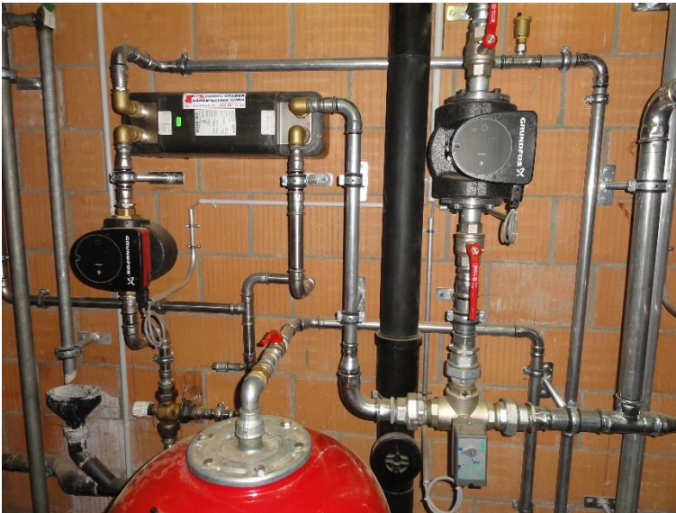
Abbildung 13: Ansicht Heizverteilung im Keller UG (unisoliert)
