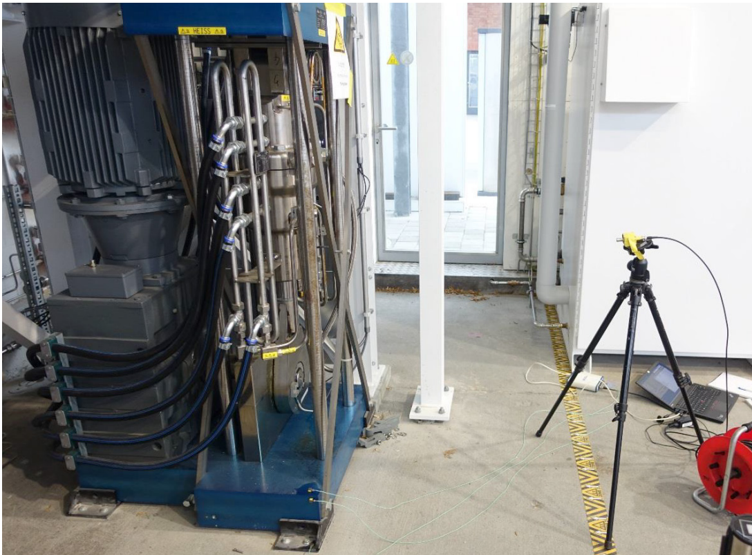
Bei der Verdichtung des Wasserstoffs auf 700 bar entsteht Lärm, der die Nachbarschaft beeinträchtigen kann. Durch eine geeignete Schallisationsvorrichtung kann dieser abgeschirmt werden. Im Bild: Vorrichtung für eine Schallmessung. Foto: Prose
