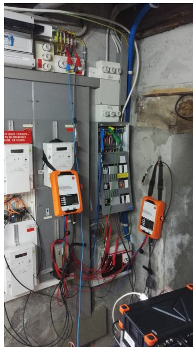
Feldmessung im Niederspannungsnetz von Avusy, einer ländlichen Gemeinde im Südwesten des Kantons Genf. Die Energieeinspeisung von zwei photovoltaischen Anlagen wird von eigenen Smart Metern gemessen. Das dritte Smart Meter misst den Energieverbrauch im Haus. Foto: D. Roggo
