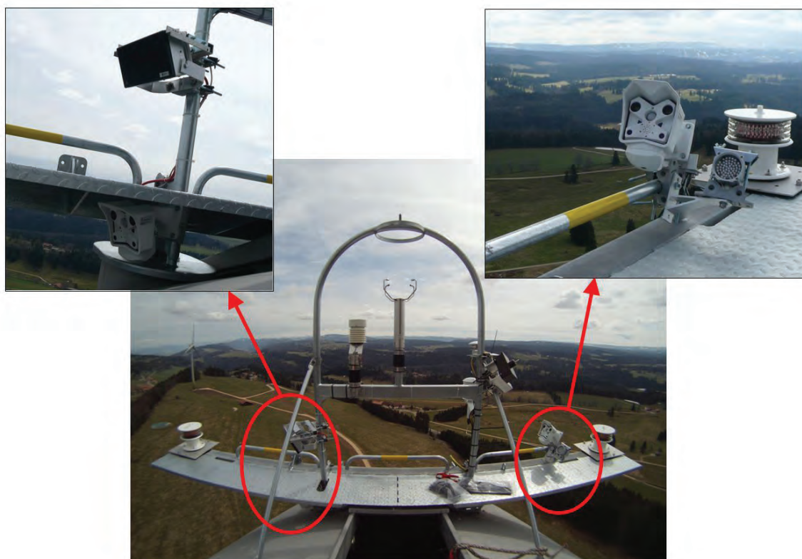
Figur 1: Installierte Kameras und IR-Scheinwerfer auf der Gondel der Windenergieanlagen in St. Brais. Links: auf das Rotorblatt gerichtete Kamera. Rechts: auf die Sensoren gerichtete Kamera.
