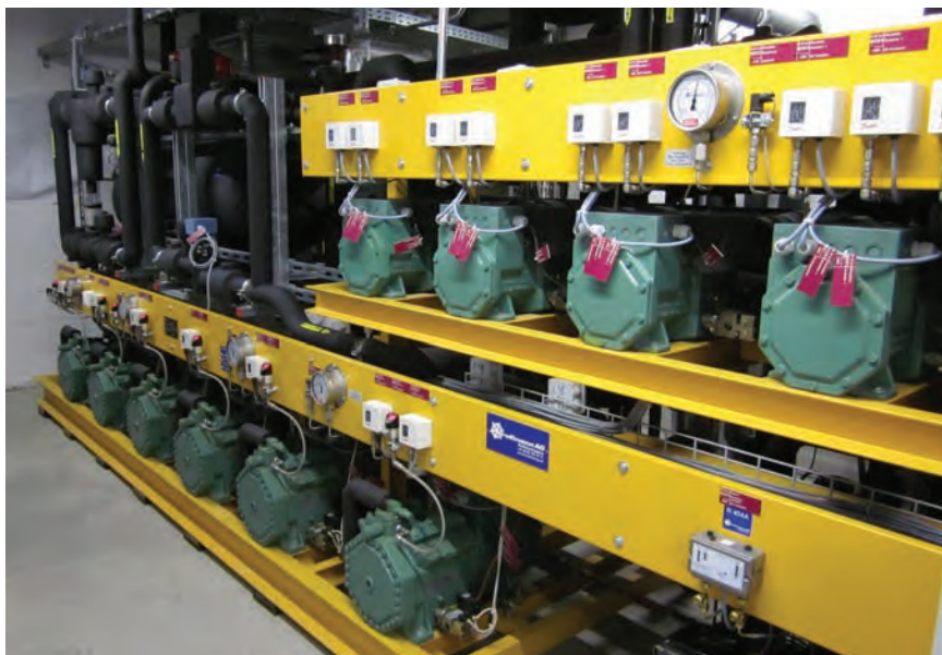
Figur 3: Transkritische CO 2 -Kälteanlage der Migros Ebikon. Anlage mit 10 Verdichtern, wovon 5 für die Pluskühlung (170 kW), 4 für die Minuskühlung (40 kW) und 1 als Parallelverdichter eingesetzt werden [10].
