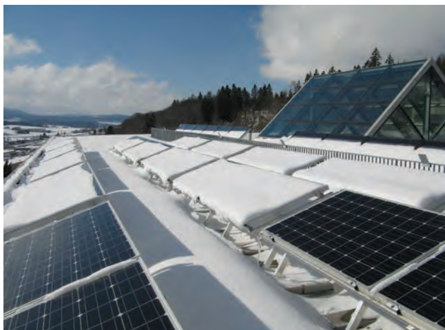
Figur 4: Zustand von schneebedeckten PV-Modulen an einem Februar-Tag mit unterschiedlichen Lösungen zur Schneentfernung (von vorne: Eulektra, Freso, Solutronic (X2) und Bosch als Referenz) (Bildquelle: Planair).
