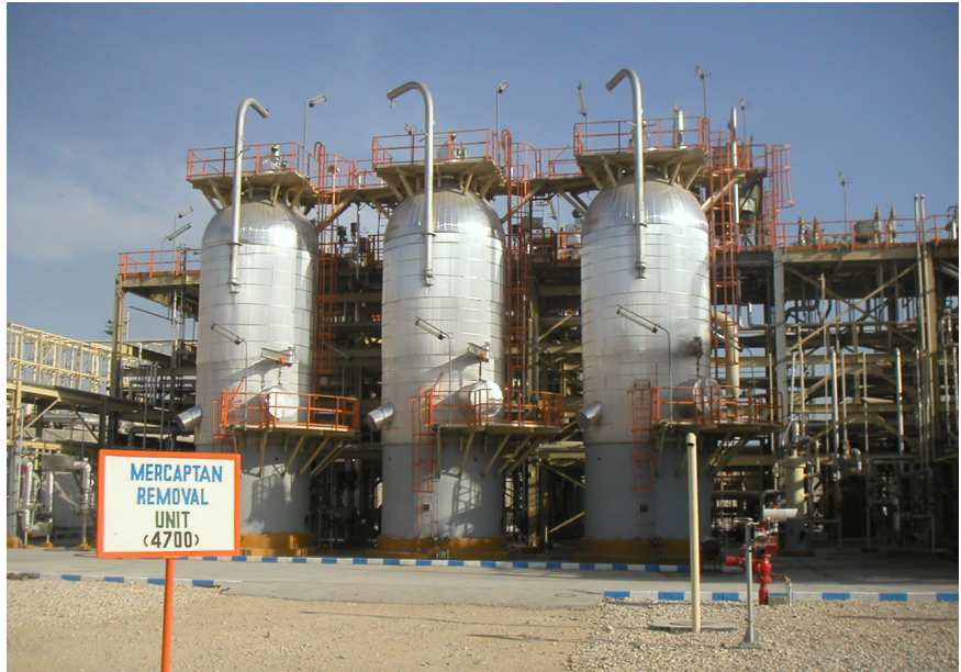
Figur 3: «Schwefelentfernung aus Erdgas mittels Zeolith»–Weltklasse-Anlage zur Entfernung von Merkaptanen aus Erdgas: Pro Bett (Turm) sind über 40 Tonnen Zeolith enthalten. Die ganze Anlage besteht aus zwei parallelen Strängen mit je 6 Betten.
