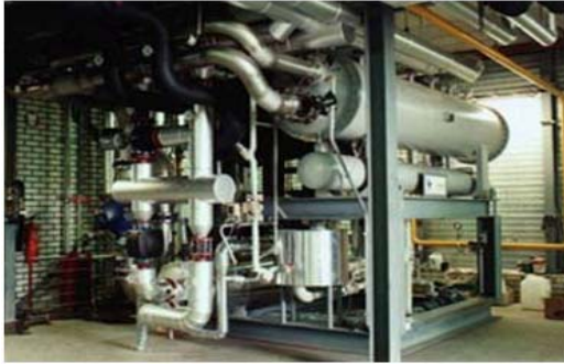
Abb. 7: Absorptionskälteanlage (Quelle FH Burgdorf)
