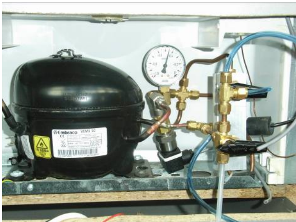
Figur 6: Installierter drehzahlvariabler Kompressor (Quelle: awtec).
