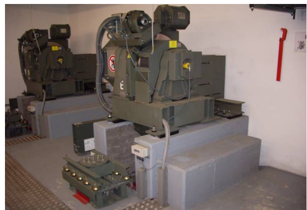
Figur 5: Liftantriebseinheit, die ausgemessen und mit dem Prototypen ausgestattet wird (Quelle: Schindler).
