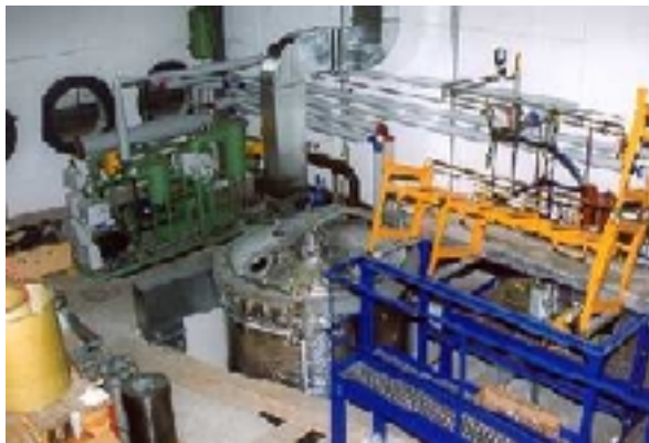
Produktionshalle des HTSL-Trafos
