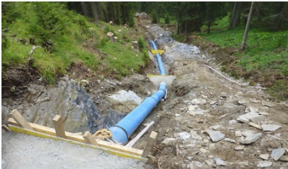
Abb. 19: Druckrohrleitung des 1.8 MW Kraftwerks Tambobach, Splügen, in Betrieb seit 2012 [51]
