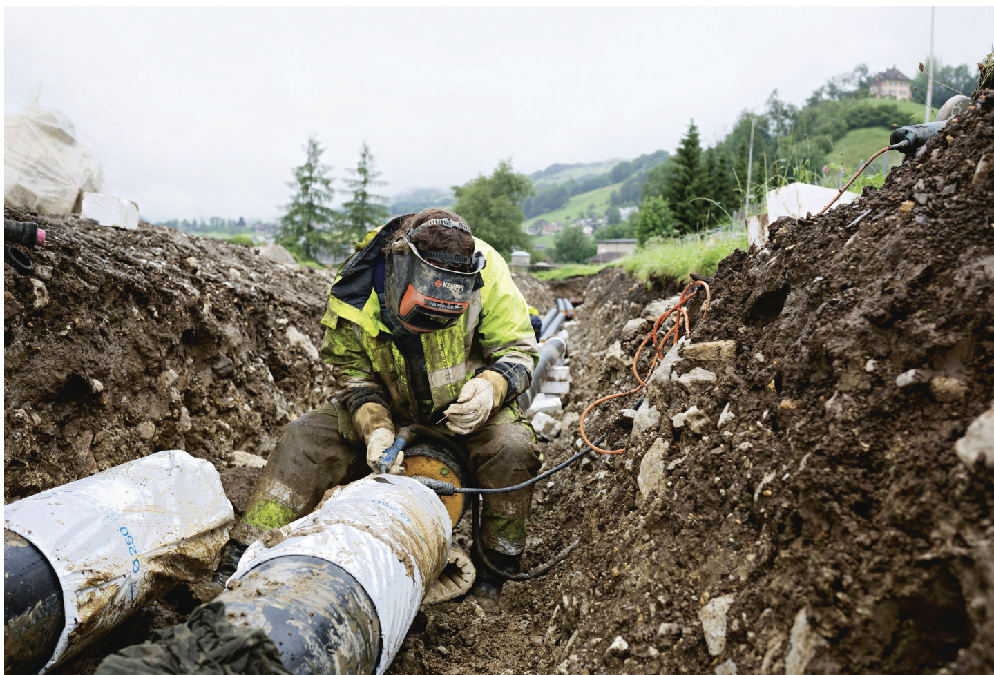
Fernwärmenetze bedürfen einer guten Isolierung, um Übertragungsverluste bestmöglich zu vermeiden. Das Wärmenetz der Agro Energie Schwyz AG (Bild) verfügt über die beste Isolation (Kategorie III). Foto: Gabi Vogt
